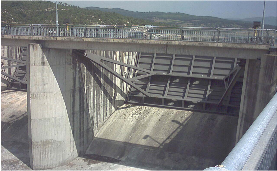
scarico superficiale con paratoie a settore
